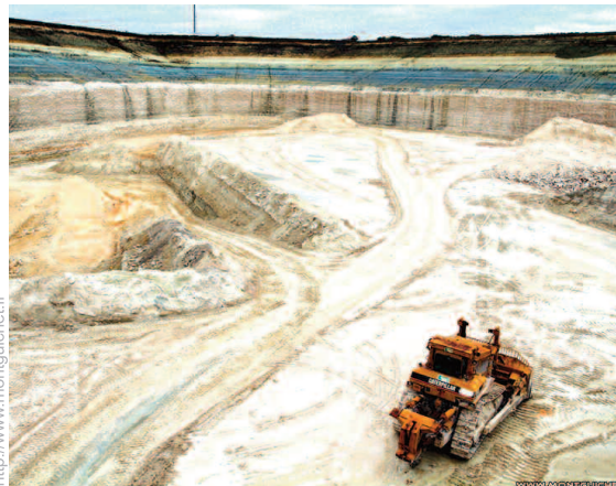
Vue d'une carrière à ciel ouvert ou l'avenir promis à la butte de l'Aulnay si la vente des parcelles de l'aqueduc de la Dhuis est accordé à BP Placoplâtre.
